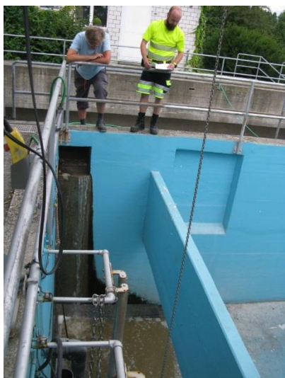
Obr. 9: Prečerpávacía stanica Giessen.
