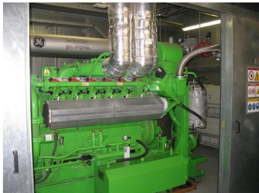
Obr. 21: Motor kogeneračnej jednotky.
